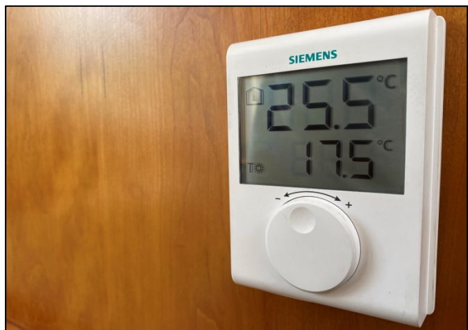
Komfortabel: Der Heizungsthermostat im Salon
